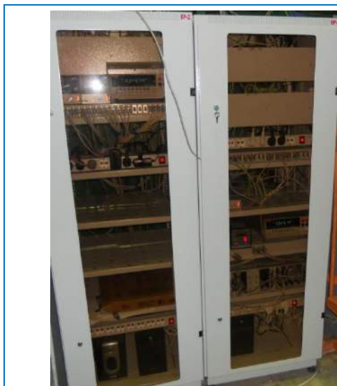
Рис. 59. Стойки систем управления и контроля криогенных замедлителей КЗ201, КЗ202, и КГУ.
