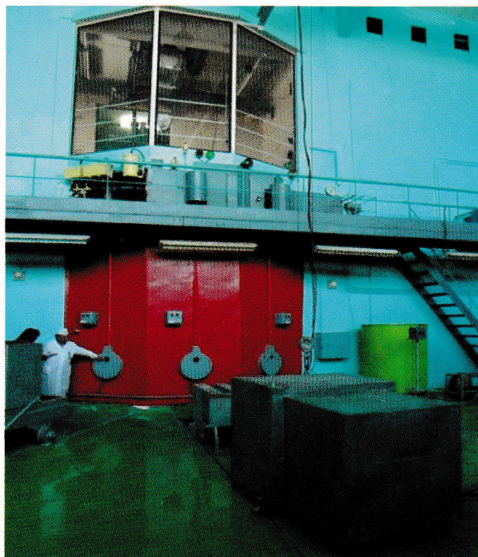
Зал вывода ГЭК ИР-100
